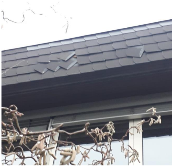
Abbildung 2: Lose Dachschindel, die Fledermäuse als Quartiere nutzen könnten
